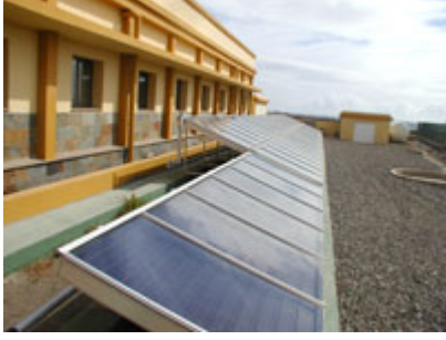
Instalación de absorción solar en las Islas Canarias
